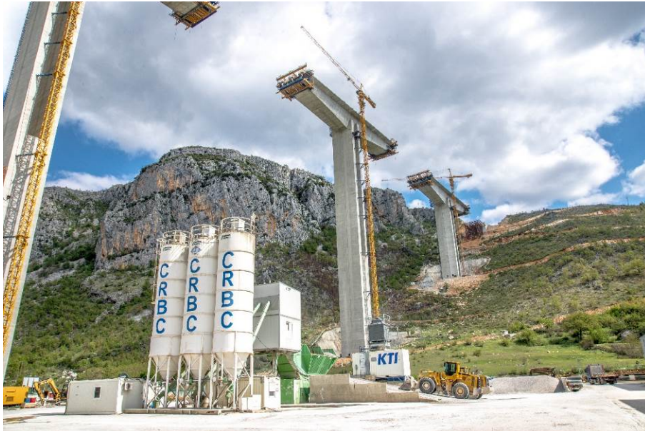
写真 2 中国の資金援助で中国企業が建設するモンテネグロの高速道路
